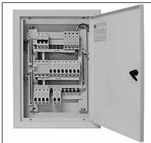
FIGURA 205 – QUADRO DE DISTRIBUIÇÃO
